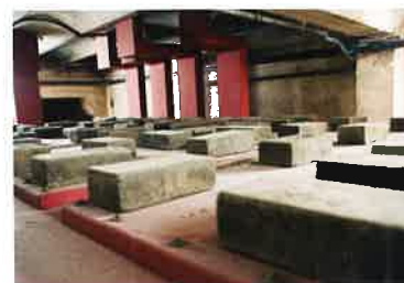
Etage de la soufflerie avec les poids sur les réservoirs
