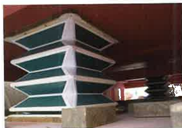
Gossiers reliant les réservoirs
