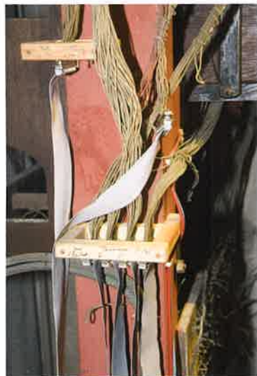
Raccord de l'informatique à l'ancien câblage de 1888
