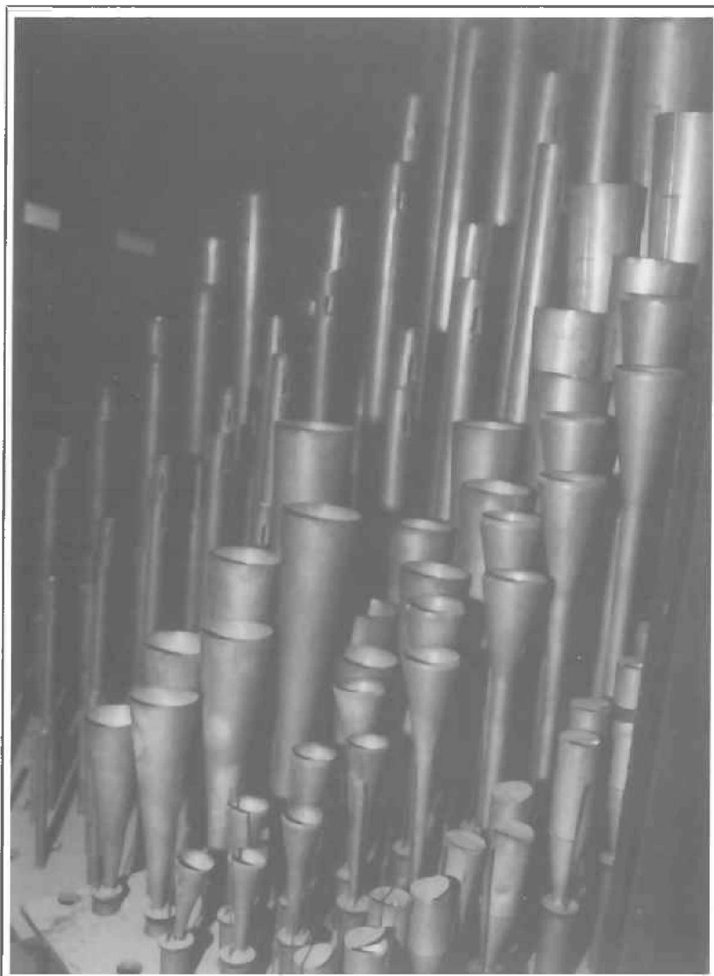
Saint-Médard - Détail de la tuyauterie du Récit
